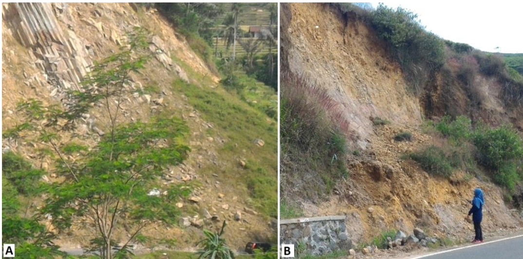
Gambar 5. Longsor batuan planar (A) dan longsor bahan rombakan (B) di pinggir jalan antara Pangalengan-Cisewu, Kabupaten Garut
