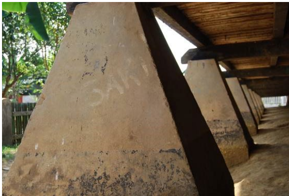
Sumber: Dok. Balai Arkeologi Banjarmasin 2009 Gambar 12 Pondasi Bangunan SD Melayu 1 / Bekas Barak Militer di Muara Teweh
