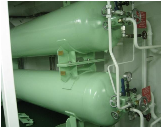
Gambar 3.3: Tabung penyimpanan udara bertekanan beserta pipa-pipa distribus
