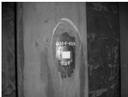
Gambar 4 : Salah satu pipa radiant tube yang diperiksa
