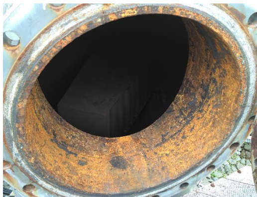
Gambar 6. Endapan ( Scaling ) dan korosi yang terjadi pada pipa uap PLTP Skala Kecil
