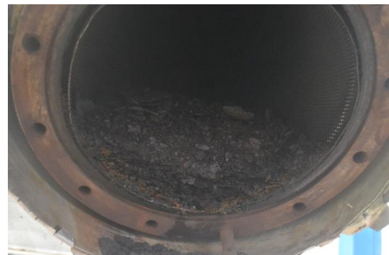
Gambar 5. Endapan ( Scaling ) yang terjadi pada pipa uap PLTP Skala Kecil
