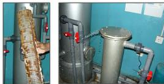
Gambar 4. Strainer Yang berkarat dan Tutup Static Mixer Yang bocor.
