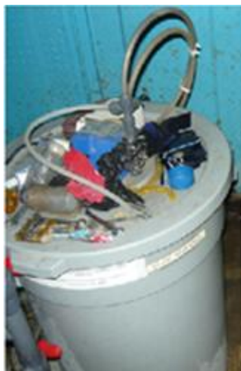
Gambar 3. Unit Pompa Dosing Yang Kurang Perawatan.
