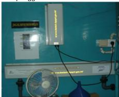
Gambar 10. Unit Disinfeksi Ultraviolet.
