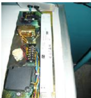
Gambar 11. Ballast Lampu UV yang Rusak.
