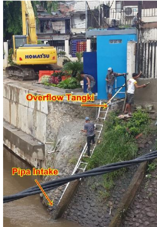
Gambar 13: Kondisi Intake Pompa dan Tangki Overflow Sistem Online Monitoring Segmen Manggarai.
