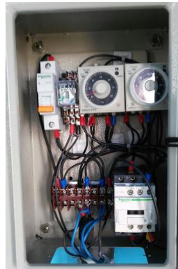
Gambar 8: Panel Kontrol Sistem Pemompaan.
