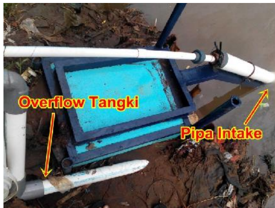
Gambar 15: Kondisi Intake Pompa dan Tangki Overflow Sistem Online Monitoring Segmen Kelapa Dua.
