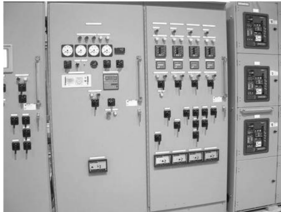
Gambar 1. Perangkat Hubung-Bagi (PHB) jenis konstruksi lemari [2] .
