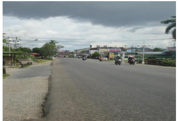
Gambar 11. Kondisi permasalahan Sta 6 – 7 jalan Adi Sucipto.
