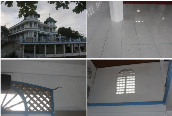
Gambar 2. Kondisi kerusakan bangunan mesjid Mujahidin
