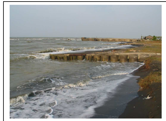
Foto 6. Kondisi Pantai Maribaya Yang Rusak Parah Walau Ada Krib, Tidak Dijumpai Adanya Sedimen Yang terperangkap.
