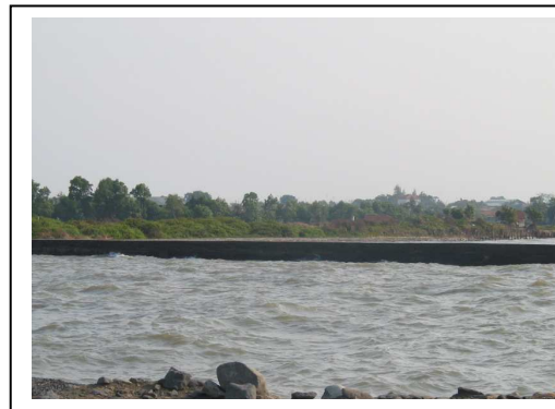
Foto 10. Kondisi Ujung Jeti Pelabuhan Tegal, Terlihat Sebelah Barat Jeti Terjadi erosi Yang Cukup Parah. (Difoto Menghadap Ke Barat).
