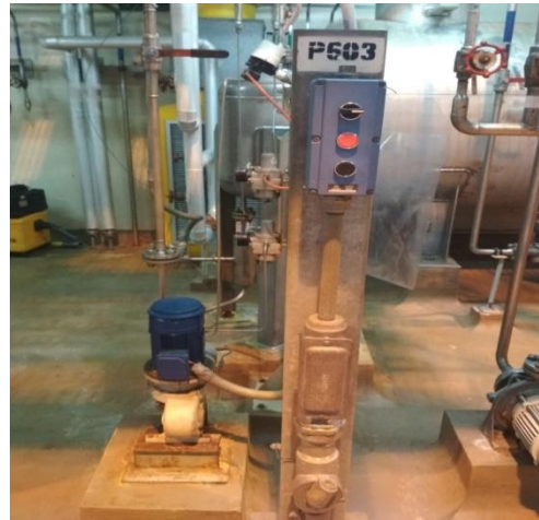
Gambar 6. Pompa Transfer UN P-603
