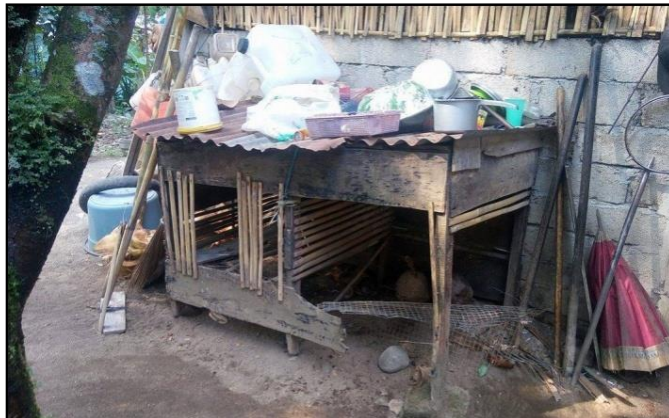
Gambar 1. Kondisi kandang yang rusak
