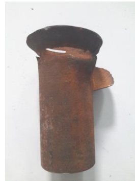
Gambar 1 Pipa desuperheater spray yang mengalami rupture
