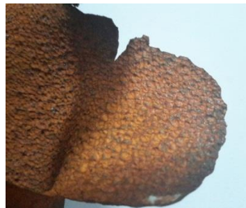
Gambar 3 Permukaan dalam pipa desuperheater spray
