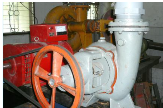
Gambar 4 Rangkaian Generator dan Pompa yang sedang diuji sebagai turbin
