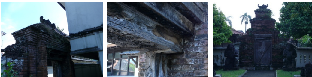
Gambar 21. Kiri: Gerbang samping kanan. Tengah: Detil kerusakan (kayu, bata busuk) gerbang samping kanan. Kanan: Gerbang samping kiri (berlumut-tumbuhan di bagian atas).
