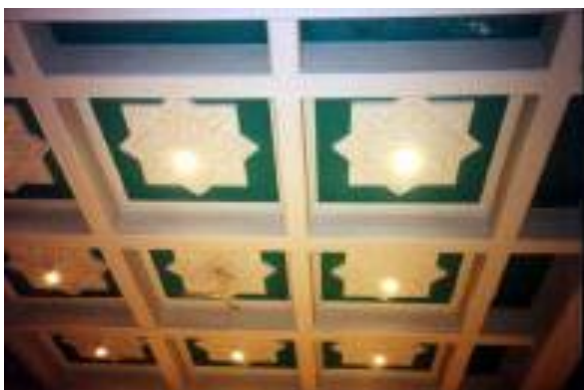
Terdapat lampu spotlight di tiap grid plafon liwan.
