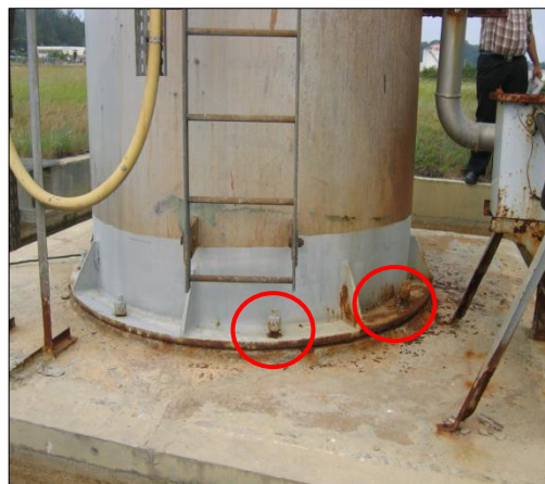
Gambar 3. Tercabutnya Baut Angker Pengikat Riser Flare Stack Base Plate
