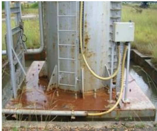
Gambar 8. Kondisi Base Plate dan Skirt Plate dari Riser Flare Stack Setelah Perbaikan.
