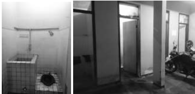
Gambar. 7 Kondisi kamar mandi rumah kos Sumber: Ujianto, 2018
