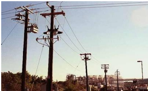
Gambar 2. Saluran Kabel Udara Tegangan Menengah
