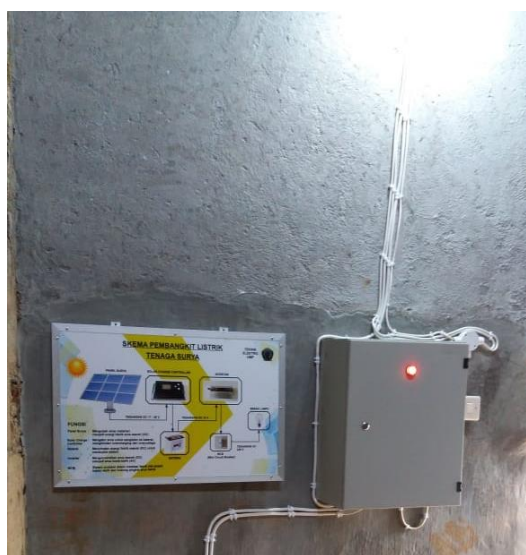
Gambar 4. Instalasi Sistem Pembangkit Listrik Tenaga Surya
