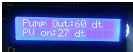
(menunjukkan pump 1 sedang menguras kolam)
