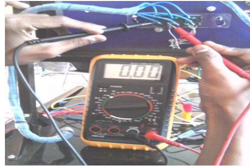
Gambar 4.8 Pengukuran Pada Saat Sebelum Lampu Nyala
