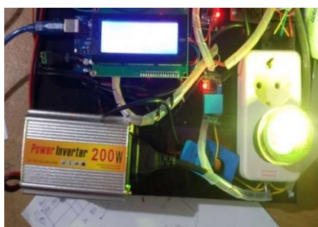
Gambar 19. Pengujian Perpindahan Dari Genset ke PLN
