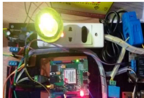
Gambar 18. Pengujian Perpindahan Dari PLN ke Genset
