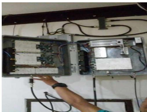
Gambar 21. Repeater Terpasang Di Ruang Server
