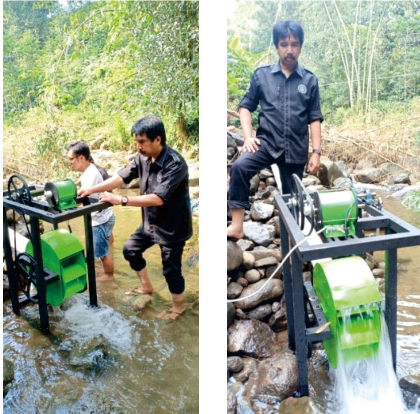
Gambar 11. Running test pembangkit listrik tenaga pikohidro
