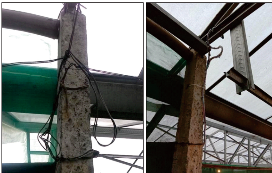
Gambar 7. Kondisi kabel sambungan dan percabangan tanpa isolasi (kiri) dan sesudah direvitalisasi (kanan)
