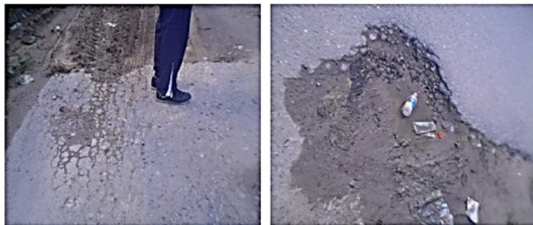
Gambar 1. Kerusakan Jalan pada Lokasi Studi (Tipe Lubang dan Retak Pinggir)
