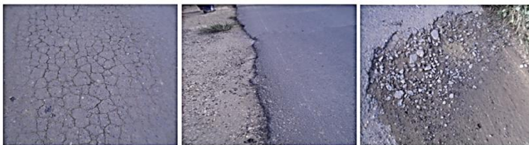
Gambar 2. Kerusakan Jalan pada Lokasi Studi (Retak Kulit Buaya, Penurunan bahu jalan dan lubang/Retak Pinggir)
